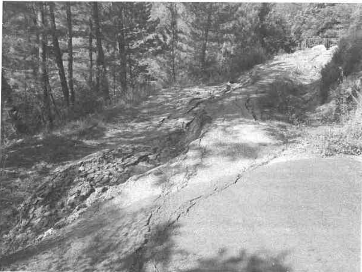
Figure 5 : Glissement de terrain en cours d'aggravation
