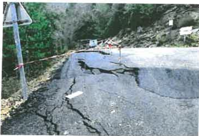
Vue de l'effondrement
